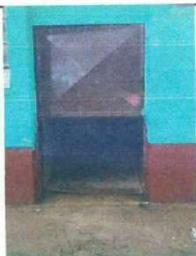
Foto 3: Se observa el deterioro una de las puertas portantes.
